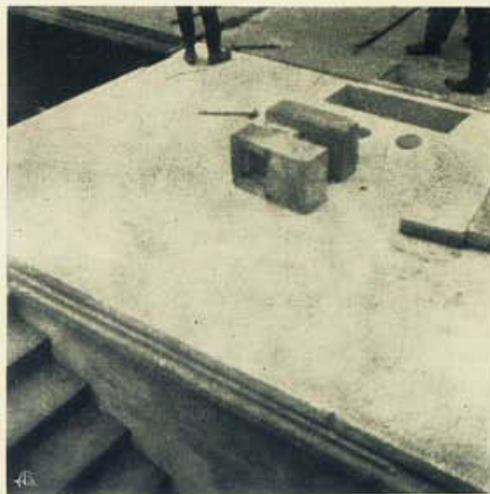
Fig. 42 — Piso de uma cozinha com aberturas rectangulares para fugas de chaminés e esgotos.
