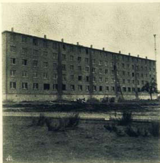
Fig. 77 — Fachadas deterioradas pelo entupimento dos tubos de queda das águas pluviais do terraço que são exteriores.
