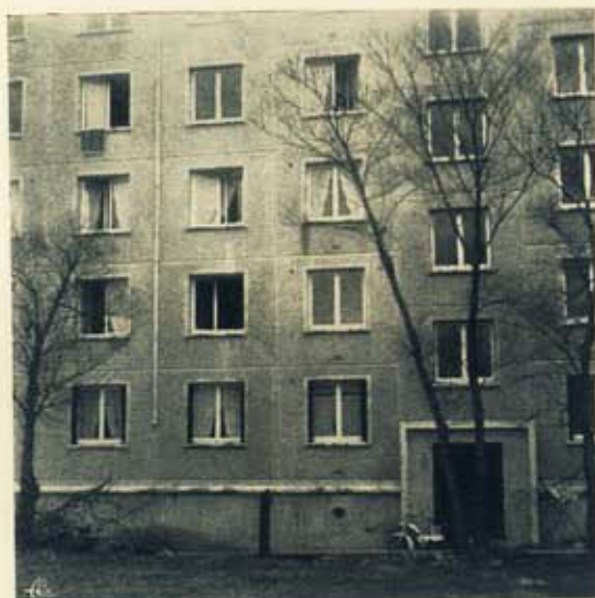
Fig. 78 — Prédio já habitado. Por cima e por baixo do vão de janela que se encontra mais aberto, há fissuras nos elementos das fachadas, que foram colmatadas.
